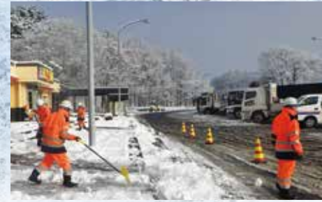
サービスエリア歩道部除雪作業 (冬期間) サービスエリアの除雪は、車を降りてからの部分も大切。安全な歩行を確保します。
