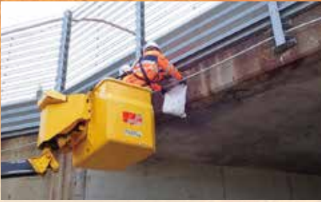
剥落対策 (10月) コンクリートの劣化による落下を防止するため、防護柵等で補強します。
